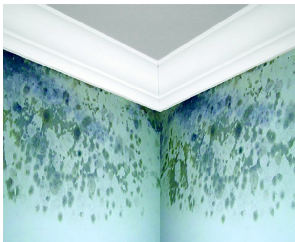
Przed usunięciem grzyba ze ściany
